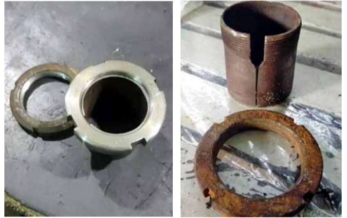
▲纳闽医院化验室冷气设备钢管破裂及营造的新配件。
